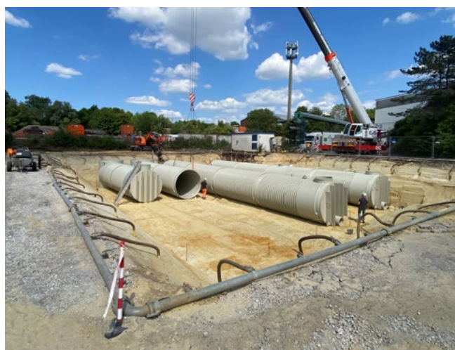
Löschwassertanks bei der Kommunalen Entsorgungsanstalt Nord-Niedersachsen (KENN), Osterholz-Scharmbeck, KENN
